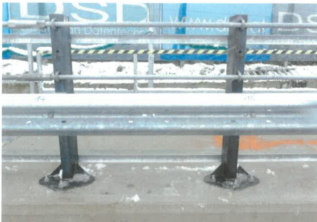
Obrázok 82: Pohľad na zábradľové zvodidlo KB 2 RH3 V-mosty
