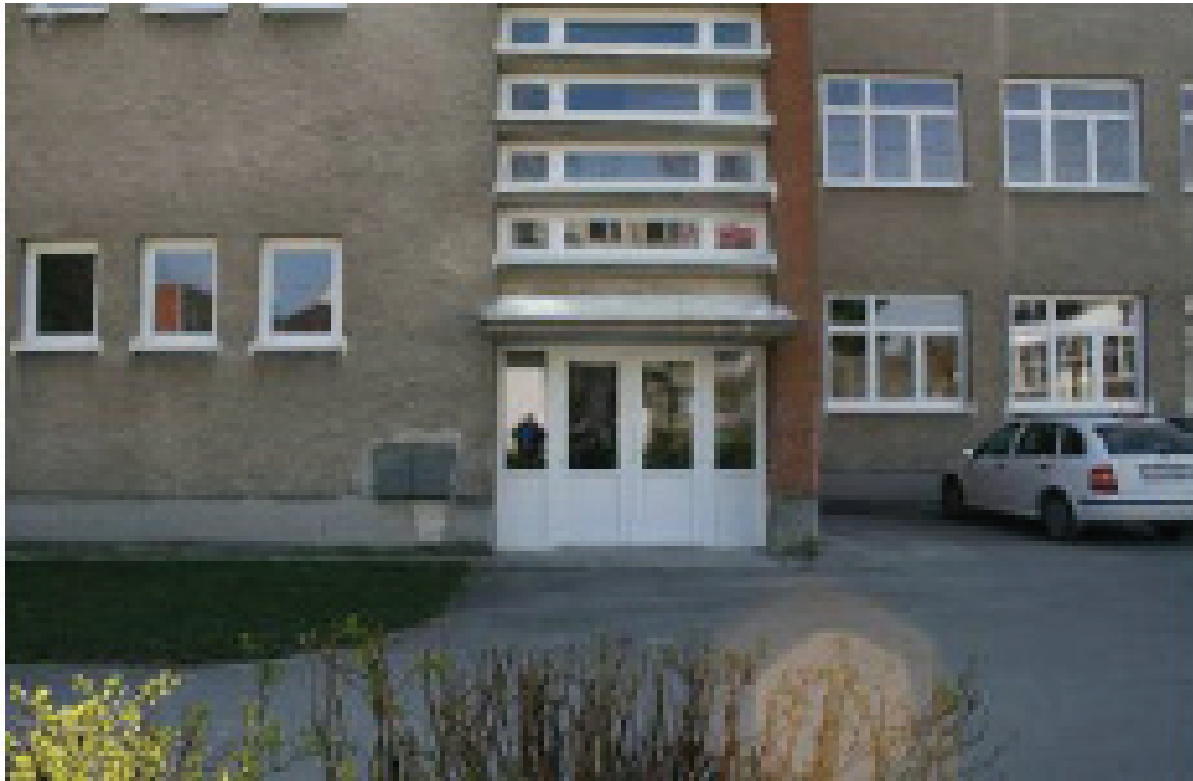
Obr. 3.3 Tepelné mosty v oblasti schodiska
