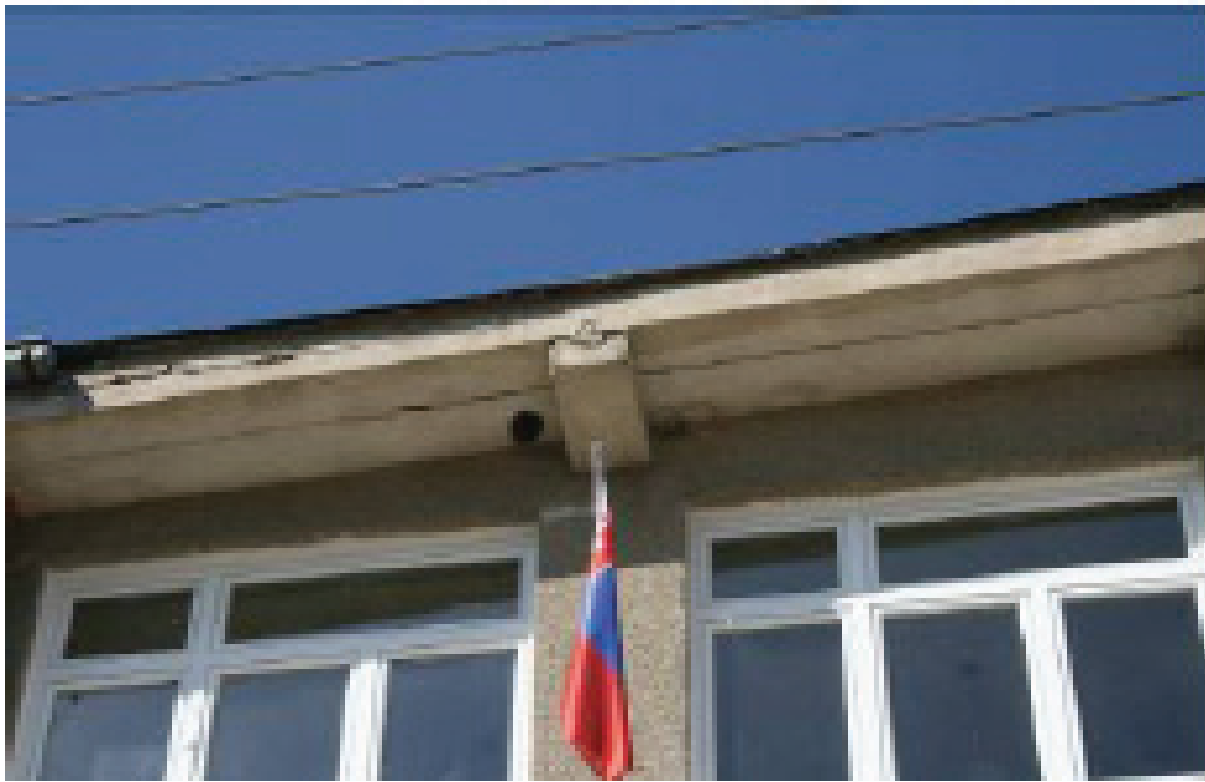
Obr. 3.1 Tepelné mosty v mieste železobetónovej rímsy
