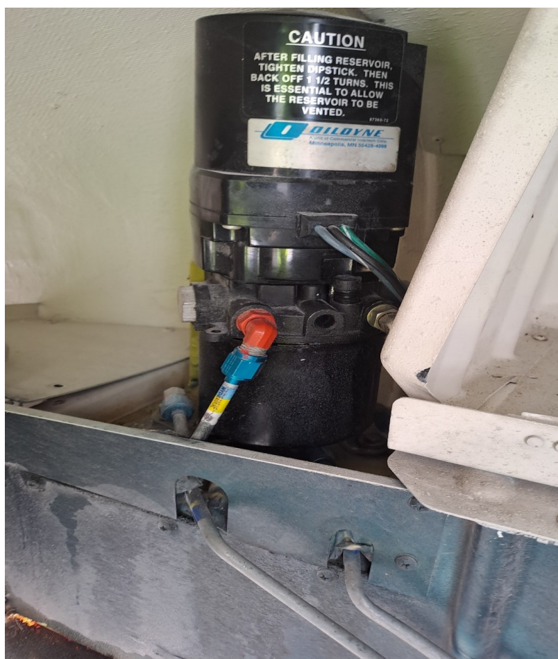
pohľad na hydraulické čerpadlo
